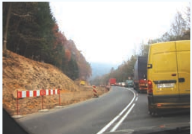
Trwająca budowa pasów wolnego ruchu na drodze nr 8 na odcinku Duszniki Zdrój – Lewin Kłodzki
